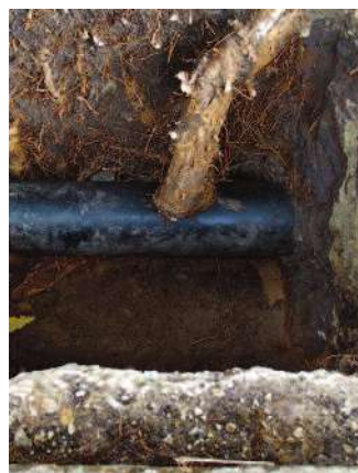
»Druckstempel« einer Eichenstarkwurzel auf einer Gasversorgungsleitung.
