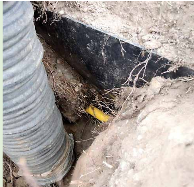
Die Gasleitung ist vollständig von Feinwurzeln umwachsen
