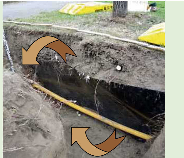
PE-Gasleitung mit vertikal eingebauter Wurzelsperre aus HDPE (Rhizomsperre)
