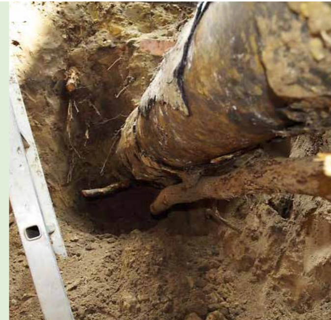
Beschädigung der bituminösen Rohrleitungsbeschichtung durch Wurzeleinwirkung
