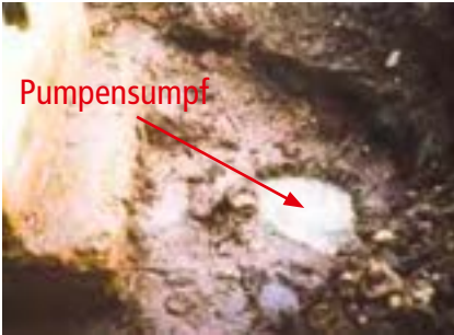
Zerstörte Abdichtungsschicht nach Einbau der Springbrunnenanlage.
