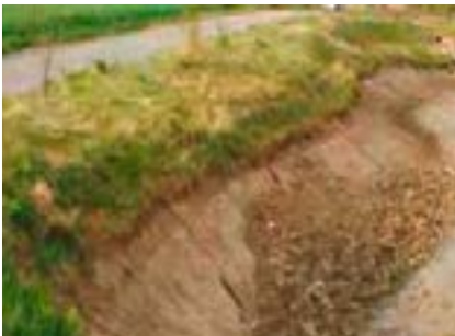
Schlickeinlagerung bis 1 m Höhe.
