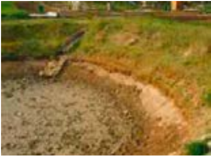
Bereich ohne Dichtung.
